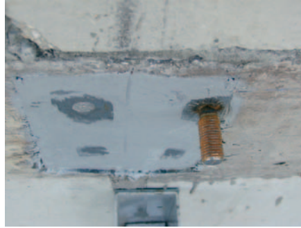
Ausgebrochener Gewindebolzen (links)
